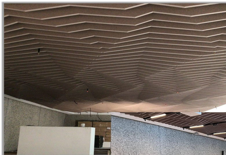
Akustisk tak av resirkulerte plastflasker
