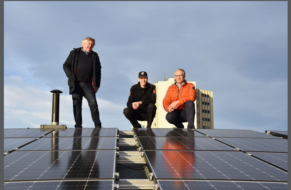
Solcelleanlegg på taket av brannstasjonen i Drammen, Foto: Drammen kommune
